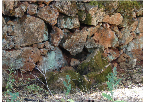
Figura 5.5. Presença de líquenes e musgo, Corriola. Fonte: Marta Gonçalves, 2021
