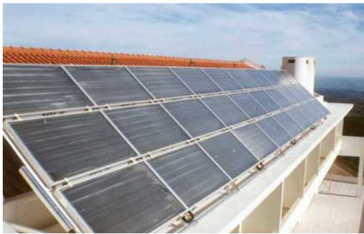
Figura 27 – Bateria colectores CPC
