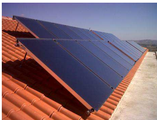
Figura 20 – Colectores planos instalados em telhado
