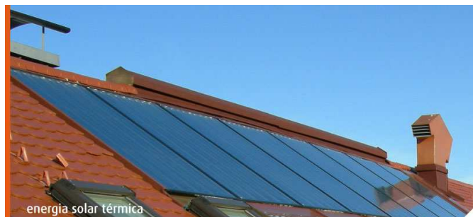
Figura 35 – Integrado no telhado
