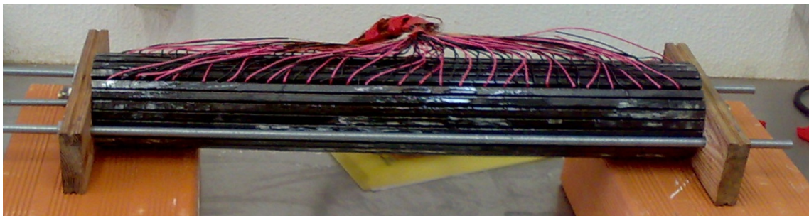
Figura 5.17 – Montagem do veio e sistema de excitação no gerador.
