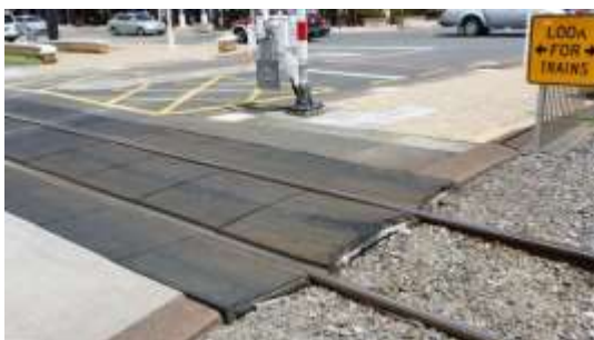
Figura 5. Exemplo de revestimento em painel de borracha numa passagem de nível
