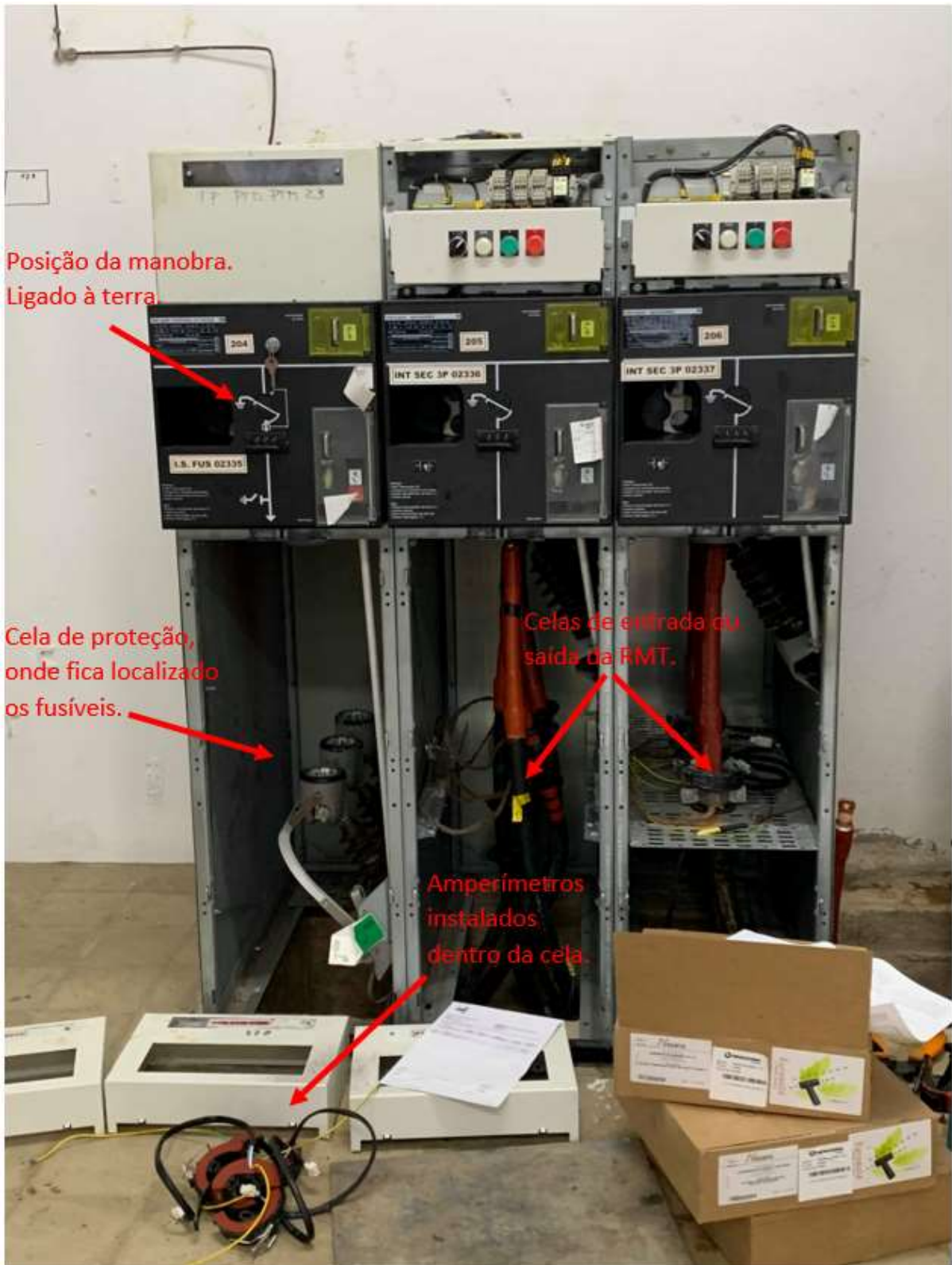
Figura 33: Equipamento de proteção e seccionamento de um Posto de Transformação.
