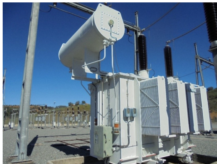
Figura 3.20 – Transformador de 12 MVA 150/27,5 kV Siemens – SST Luzianes.
