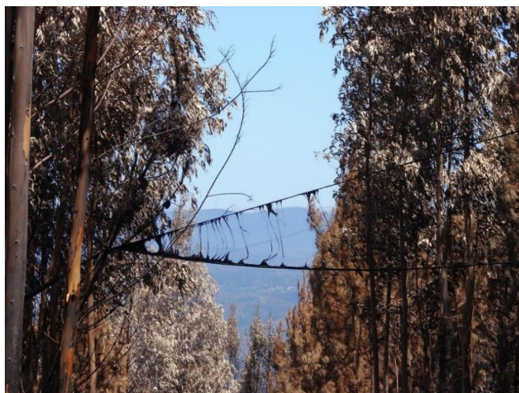
Figura 5 – Fios eléctricos incinerados na freguesia em estudo
