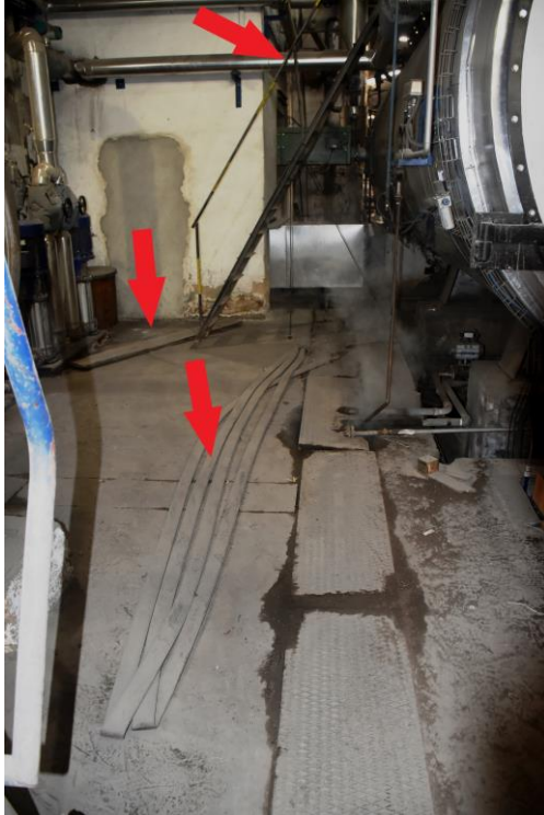
a) Posto de Trabalho 'Caldeira'. Objetos "largados" no chão.
