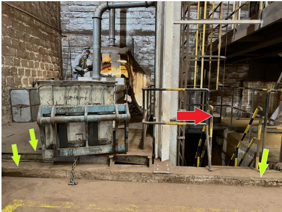
b) Posto de Trabalho 'Trituração'. Riscos mecânicos: quedas ao mesmo nível e quedas em altura.
