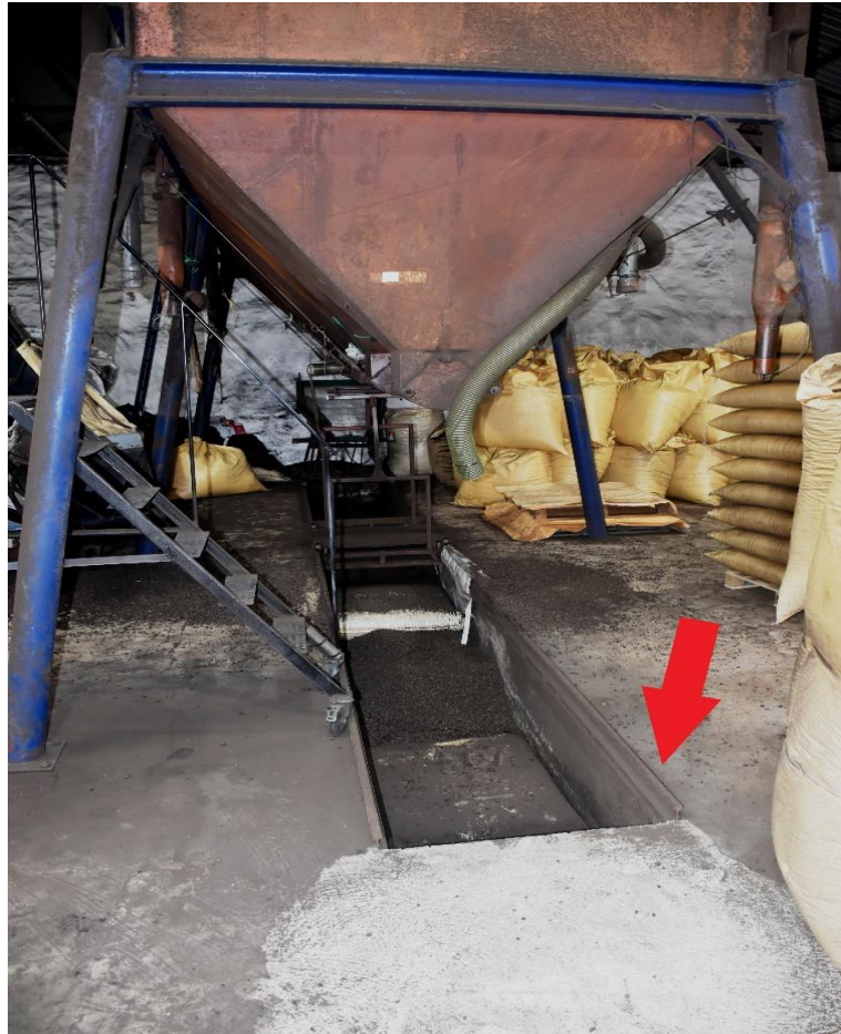
a) Posto de Trabalho 'Regranulados'. Riscos de Quedas
