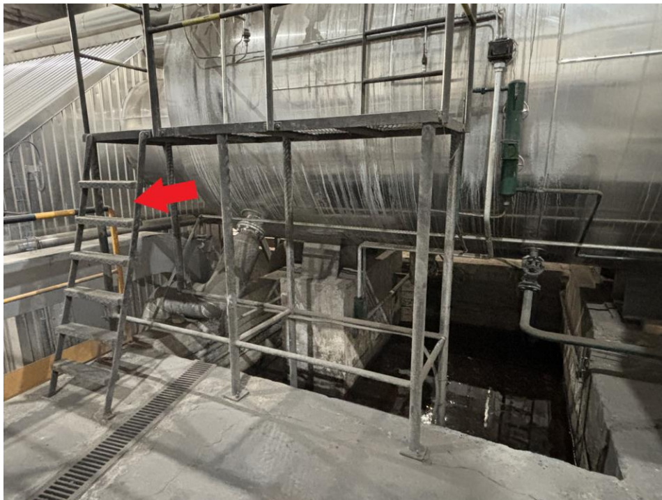
c) Posto de Trabalho 'Caldeira'. Escadas sem proteção (total) ou parcial. Objetos "largados" no chão.
