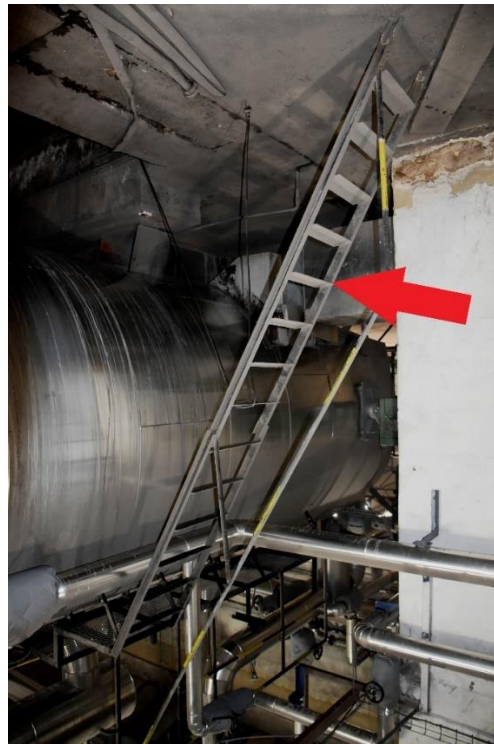
b) Posto de Trabalho 'Caldeira'. Escadas sem proteção (total) ou parcial.
