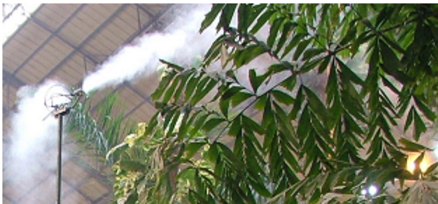
Figura 2.10 - Sistema de arrefecimento evaporativo por nebulização (Atocha, Madrid).
