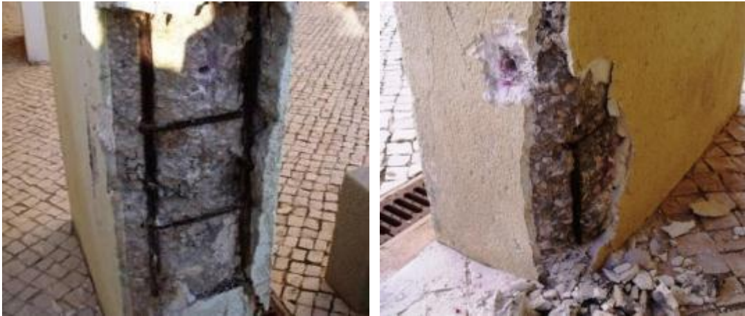
Figura 65 – Delaminação do betão em pilares exteriores
