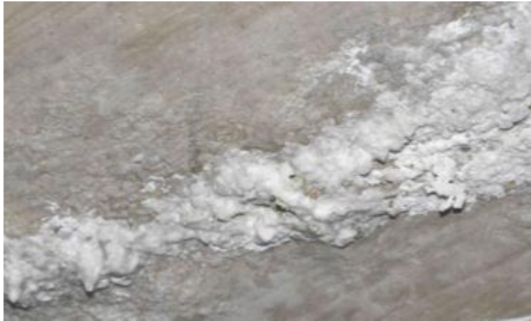
Figura 22 – Eflorescência devido à lixiviação do betão
