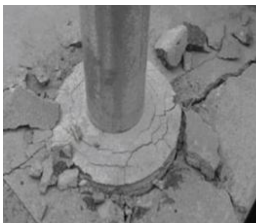
Figura 19 – Betão deteriorado pela formação de etringita [48]
