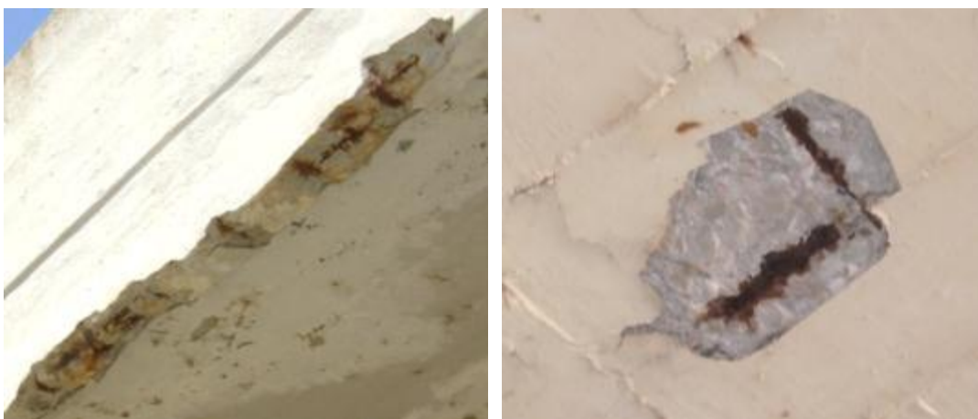
Figura 89 – Degradação do betão armado por corrosão de armaduras
