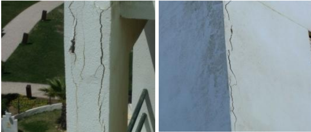
Figura 68 – Fissuração do betão em pilares exteriores
