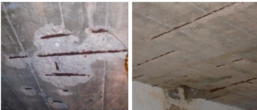
Figura 72 – Deterioração do betão armado na laje do teto da cave
