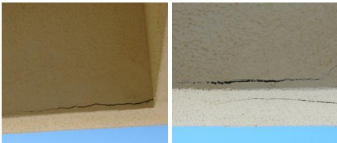
Figura 77 – Fissuração em vigas
