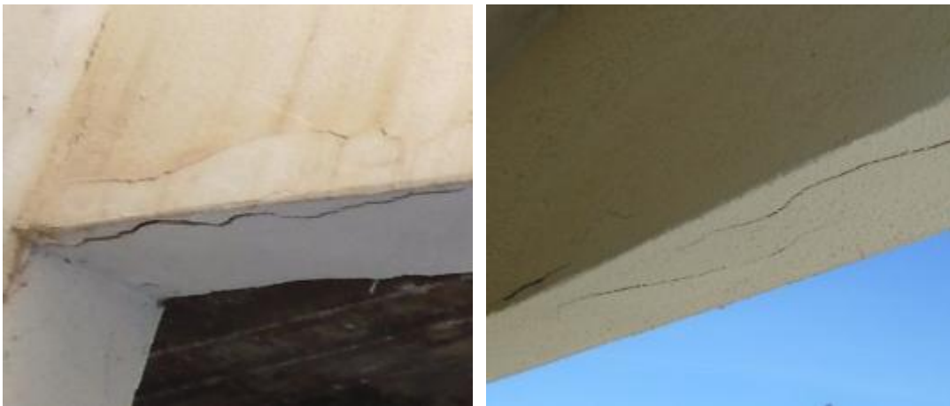
Figura 76 – Fissuração em vigas
