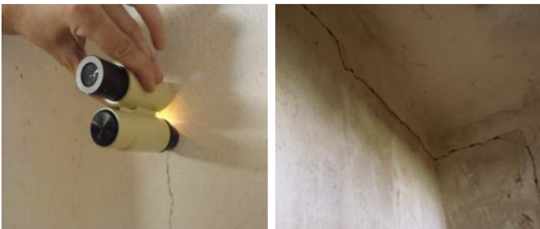
Figura 83 – Medição de abertura de fissura (figura da esquerda); Fissuração (figura da direita)
