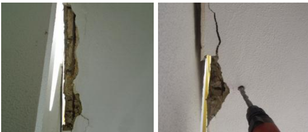
Figura 74 – Corrosão de armaduras e delaminação em lajes de escada
