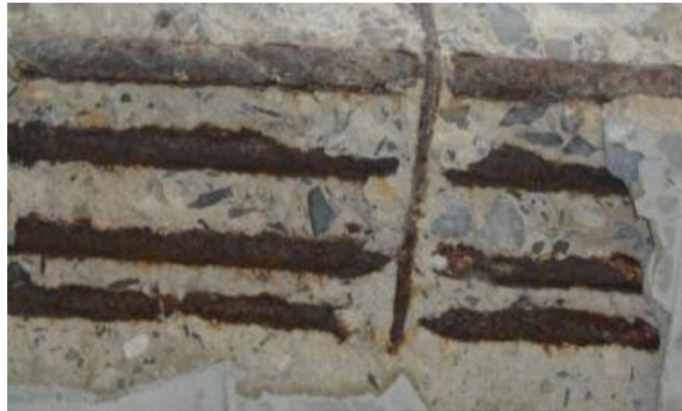
Figura 3 – Corrosão generalizada de armaduras numa viga de betão armado
