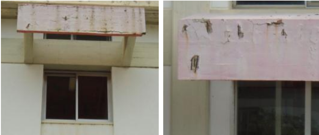
Figura 90 – Degradação de palas de sombreamento em betão armado
