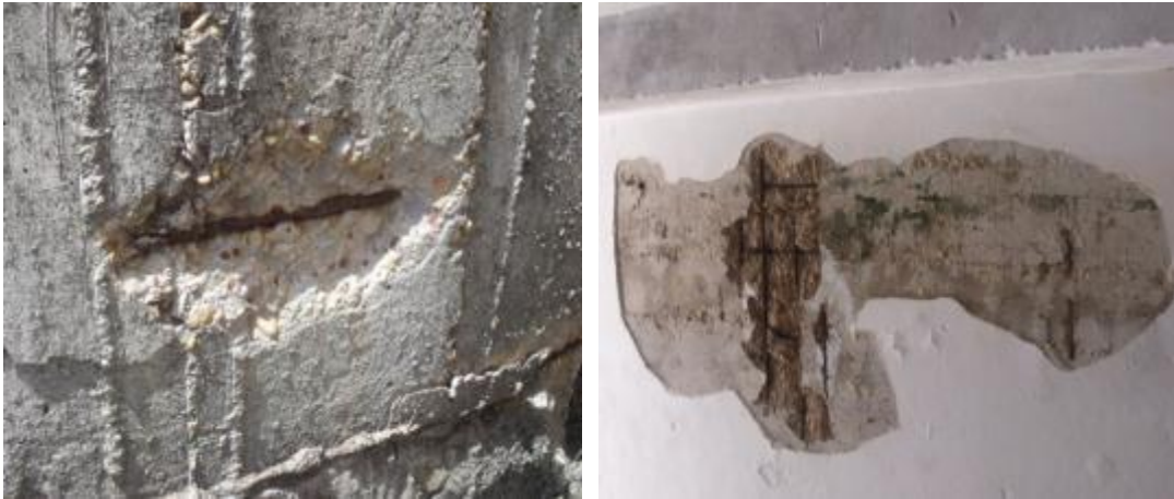
Figura 81 – Delaminação do betão devido à corrosão de armaduras
