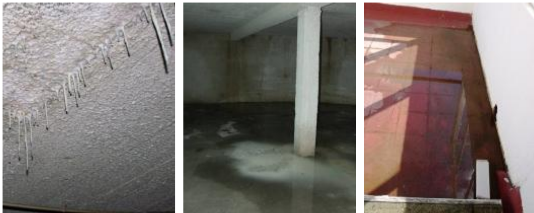
Figura 69 – Estalactites no teto da cave e empoçamentos na cave e na cobertura
