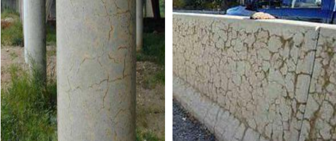
Figura 21 – Aparência característica relacionada com reações RAA no betão [51]
