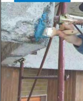
Aplicação a pincel de Mapefer 1K sobre ferros de armadura dum varanda em betão armado
