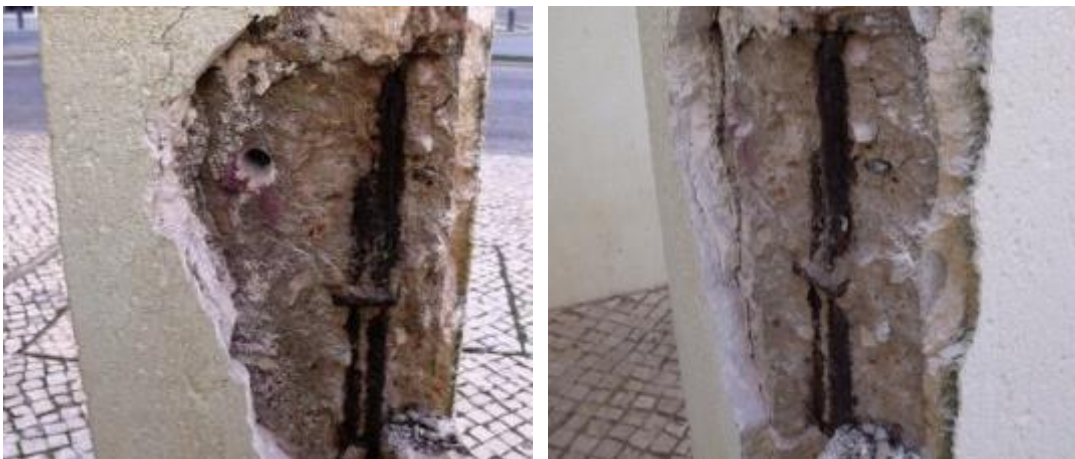
Figura 66 – Desprendimento do betão e oxidação de armaduras
