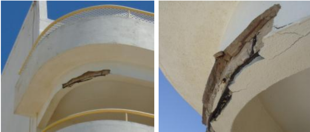
Figura 75 – Corrosão de armaduras com desprendimentos de betão em varandas
