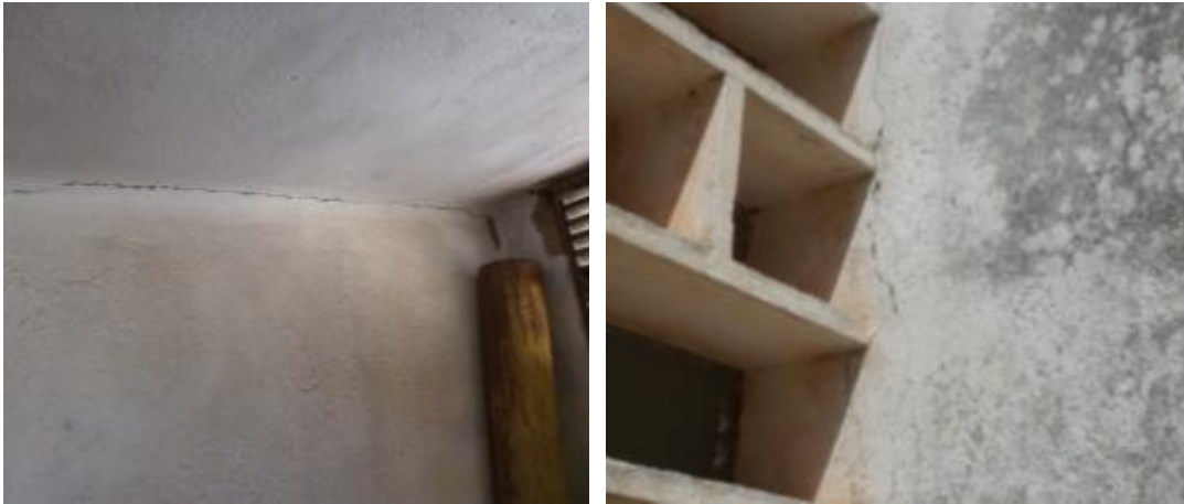
Figura 84 – Manifestações de fissuração
