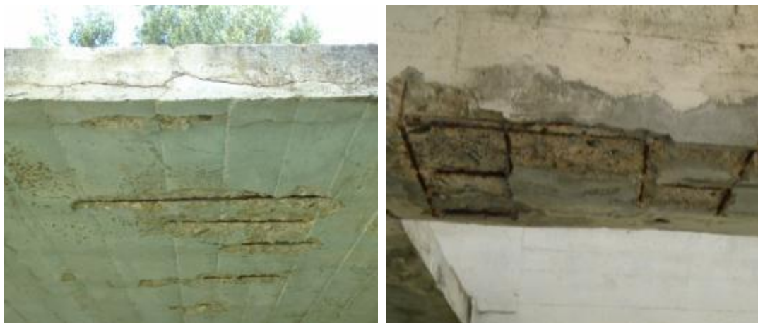
Figura 92 – Degradação do betão armado por corrosão das armaduras
