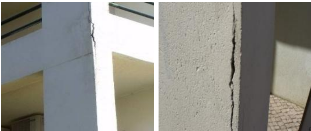
Figura 67 – Fissuração do betão armado em elementos estruturais
