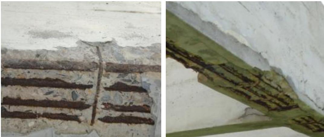
Figura 91 – Corrosão generalizada das armaduras
