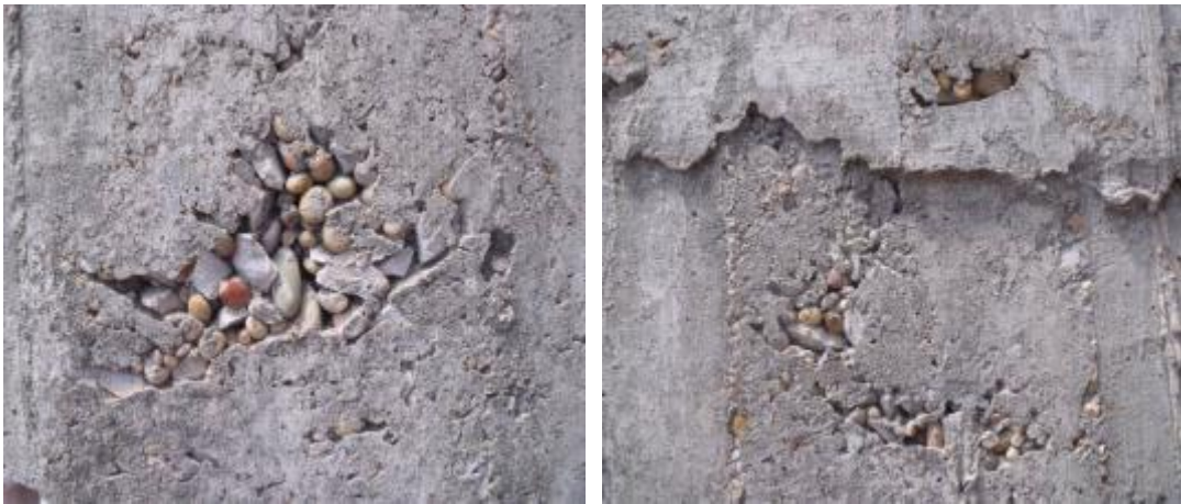
Figura 82 – Segregação do betão originada no processo de betonagem
