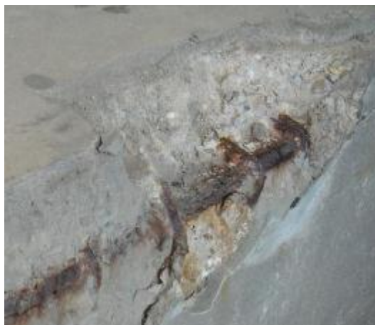
Figura 13 – Corrosão generalizada induzida por carbonatação do betão
