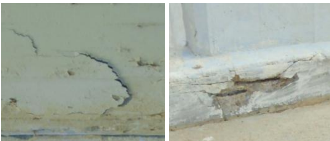
Figura 88 – Empolamento e delaminação do betão
