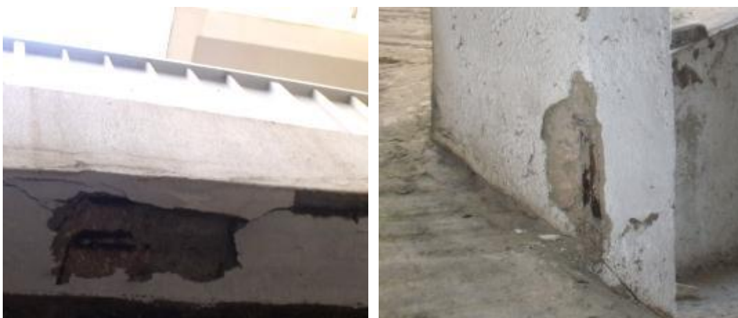
Figura 73 – Deterioração do betão armado em viga e pilar da cave
