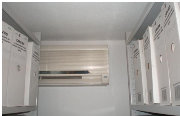
Fig. 29: Aparelho de ar condicionado, do depósito do Arquivo Histórico Municipal de VRSA.
