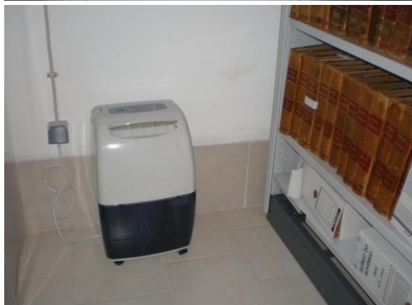
Fig. 30: Desumidificador do depósito do Arquivo Histórico Municipal de VRSA.
