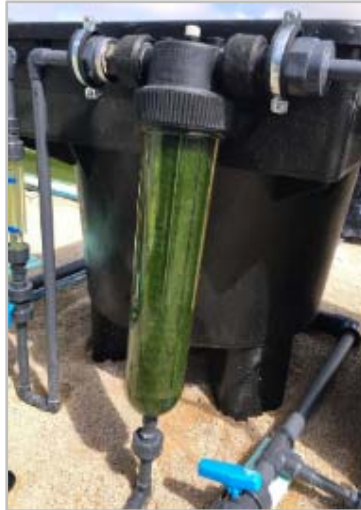
Figura 7 - Filtro a jusante da Decantação/Sedimentação
