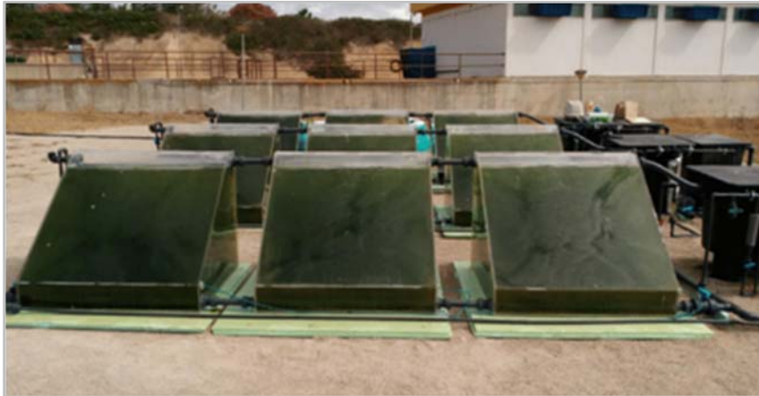
Figura 3 - PBR instalados na ETAR da Quinta do Lago, ao abrigo do projeto GreenTreat
