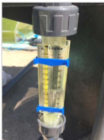
Figura 5 - Rotâmetro instalados na entrada de cada uma das linhas
