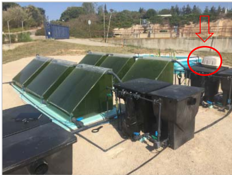
Figura 8 - Compressor para arejamento dos PBR
