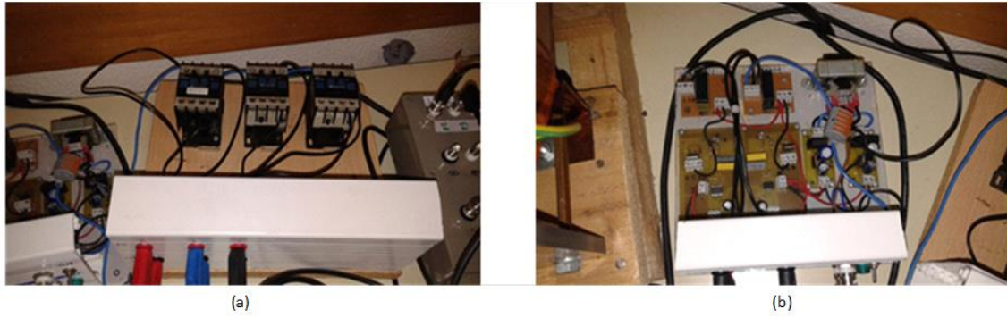
Figura 4.3 – (a): Fotografia dos contadores utilizados na abertura/fecho das linhas de alimentação do transformador; (b): Fotografia dos protótipos laboratoriais desenvolvidos para controlar o instante da introdução do defeito e a abertura/fecho dos contadores.
