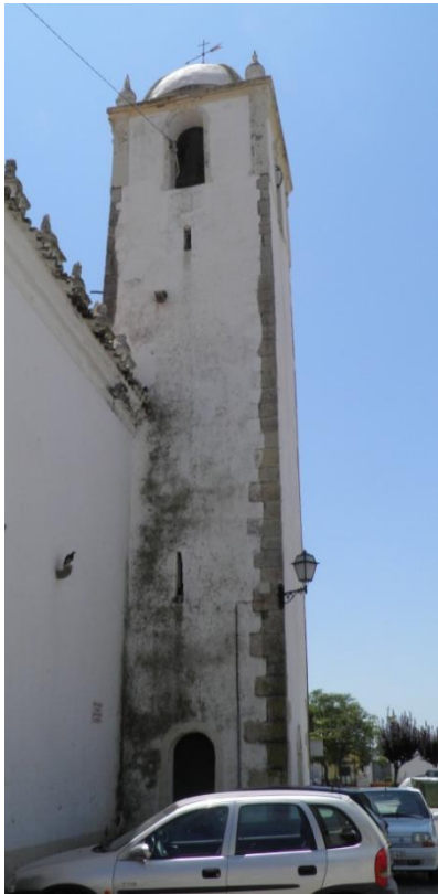
Fig. 86. Aspecto geral da torre sineira da igreja da Luz de Tavira (fachada Este). (foto do autor)
