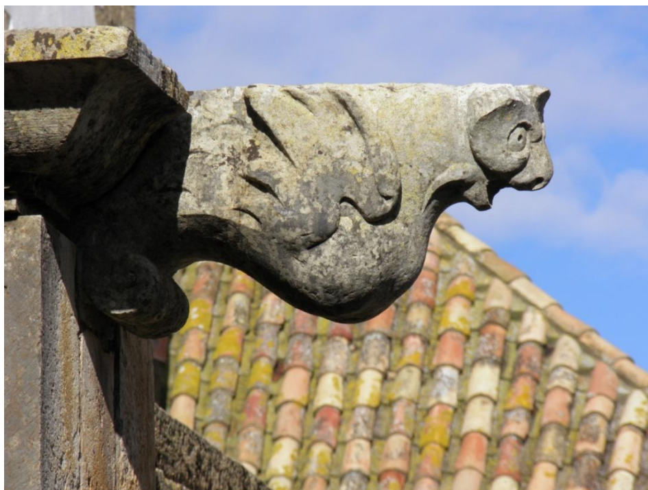
Fig. 32. Gárgula no claustro do convento de Nossa Senhora da Assunção, em Faro. (foto do autor)
