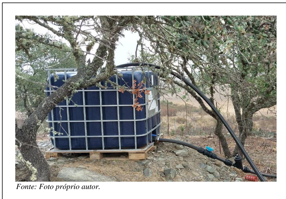
Figura 5.3 Sistema de rega – depósito
