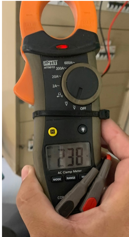
Figura A.17 - Medições na Iluminação LED (1)
