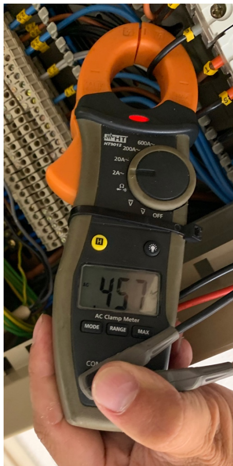
Figura A.18 - Medições na Iluminação LED (2)
