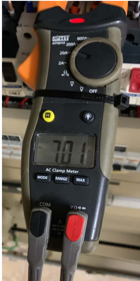
Figura A.26 - Medições no Sistema de bombagem (3)
