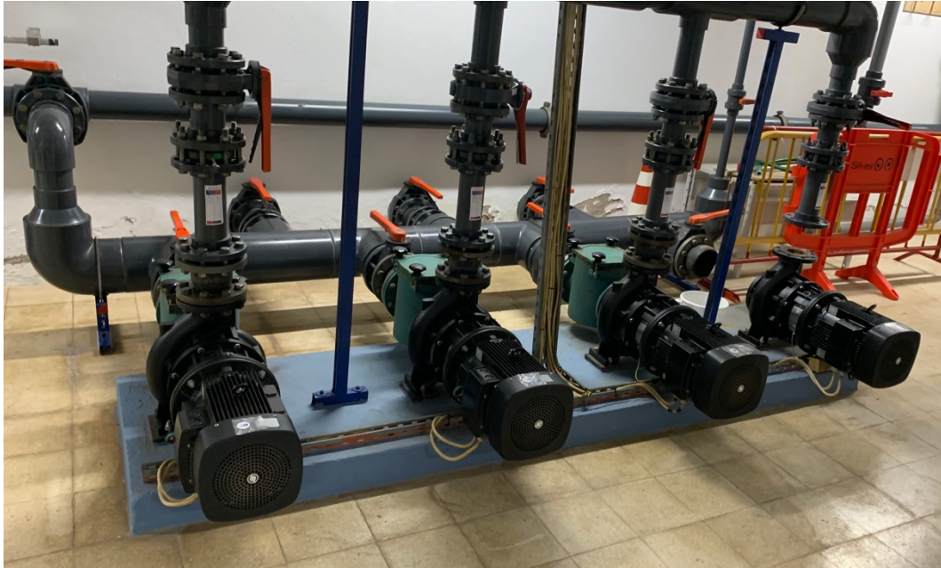
Figura A.22 - Sistema de bombagem
