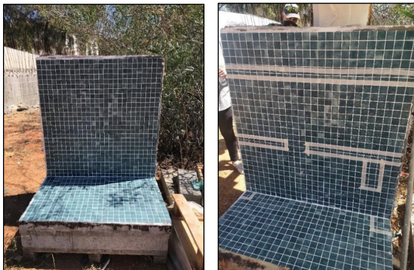
Figura 104 Mapeamento zonas ocas – Parede experimental mal colada
