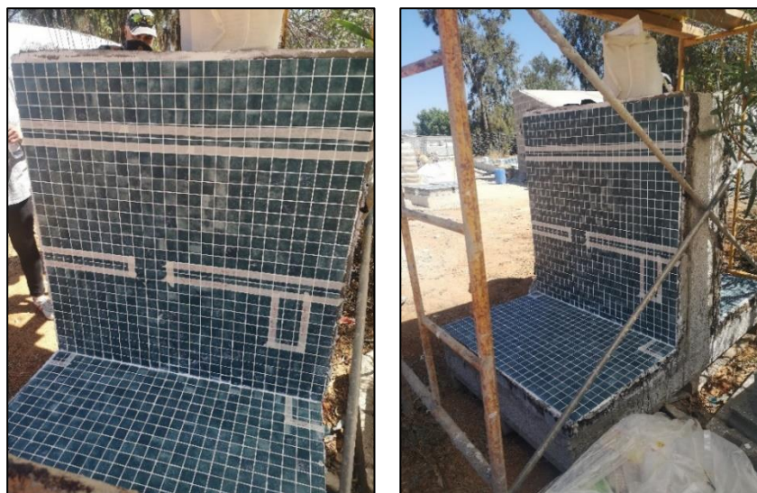
Figura 64 Mapeamento das áreas de risco – Ensaio de percussão parede experimental
