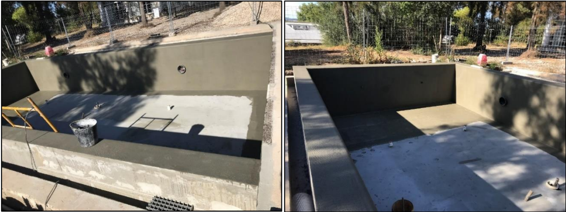
Figura 40 Aplicação da argamassa de impermeabilização com rede de fibra de vidro no interior do tanque (a)
