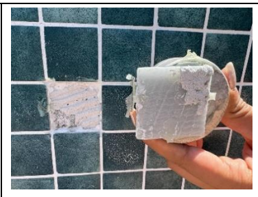
A6 – Rotura Coesiva “b”
