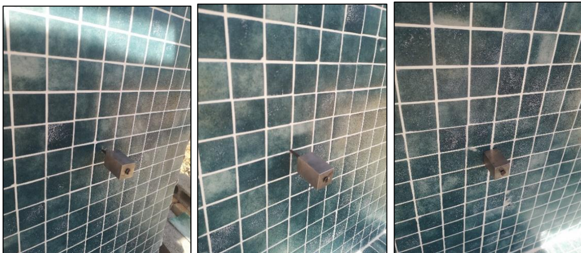
Figura 112 Parede experimental 2 - Mal colada, pastilha (esquerda) cruzamento de juntas (meio), junta vertical (direita)
