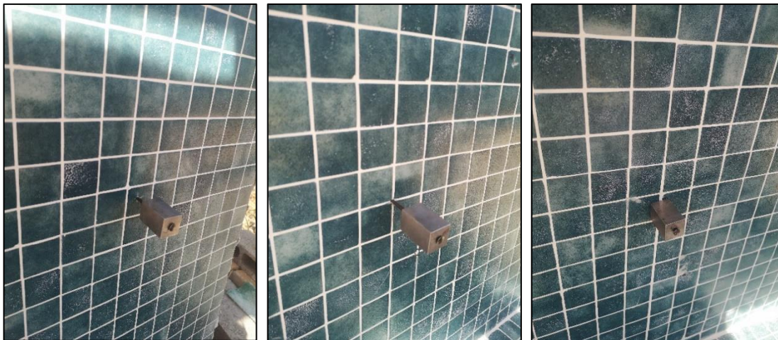
Figura 82 Parede experimental 2 - Mal colada, pastilha (esquerda) cruzamento de juntas (meio), junta vertical (direita)
