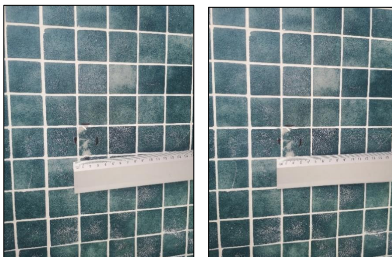
Figura 76 Ensaio de choque de esfera – Parede experimental 2 – Mal colada
