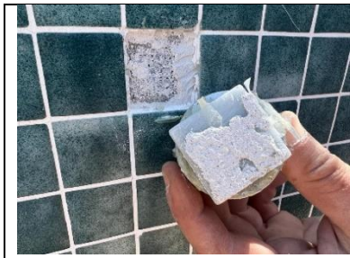
A9 – Rotura Coesiva “b”
