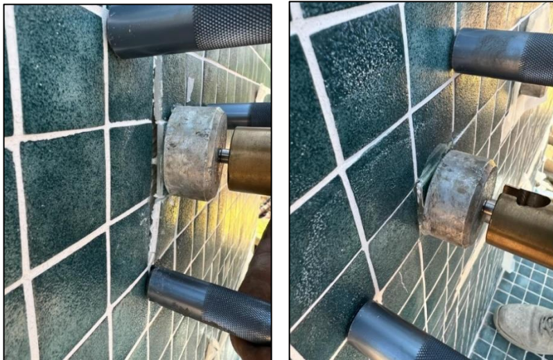
Figura 91 Arrancamento das amostras na parede experimental 2 – mal colada
