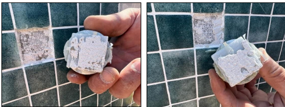
Figura 92 Resultado do arrancamento das amostras na parede experimental 2 – mal colada
