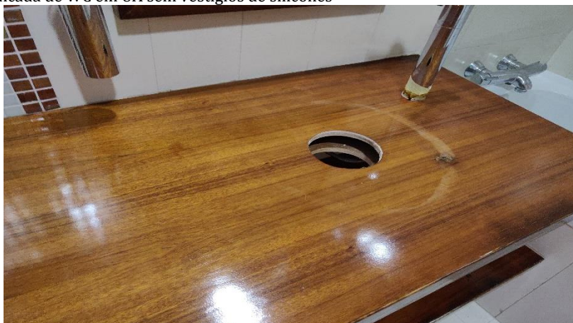
Figura 3.8 – Bancada de WC em UA sem vestígios de silicones
