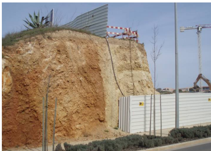
Figura 10: Aspecto da zona da falha em Janeiro de 2007.
