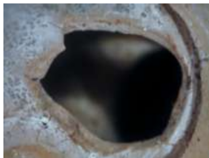
Fig. 25 – Fissuras no contorno da perfuração (nº 13)
