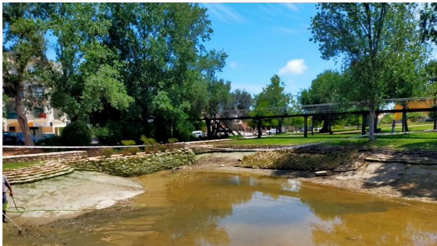
Figura 16. Foto da acumulação proveniente da rotura junto ao descarregador.
