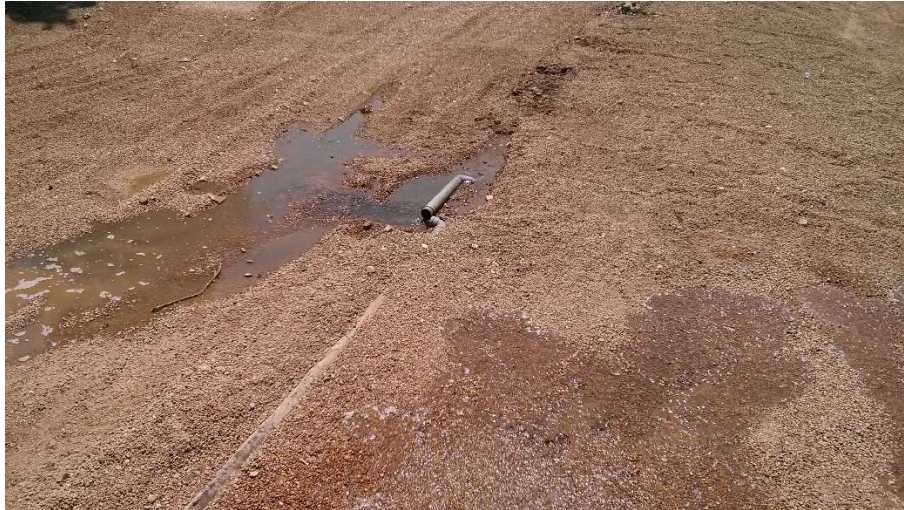
Figura 15. Foto da rotura localizada no ramal 3 (R3).
