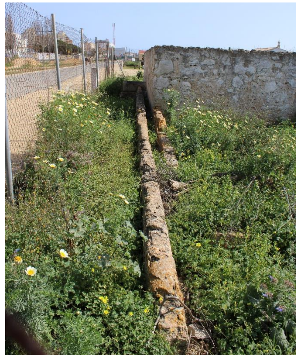
Figura 5.6 - Troço de levada interrompido a poucos metros da saída do tanque (fotografia da autora).
