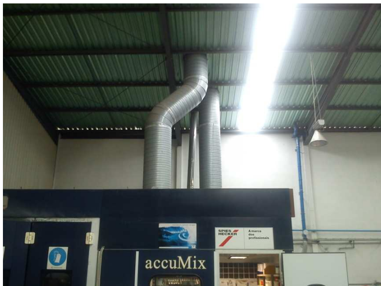
Ilustração 28 – Pormenor das chaminés (extracção, insuflação e gases queimador)
