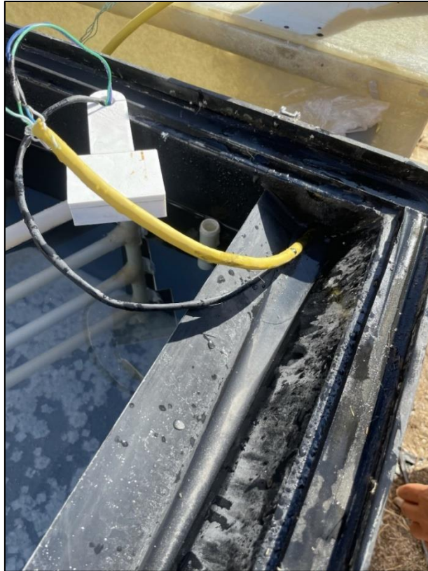
Figura II.8. Pormenor da caleira para recolha de água dessalinizada nos tanques do sistema experimental, na empresa TechSalt, Loulé.
