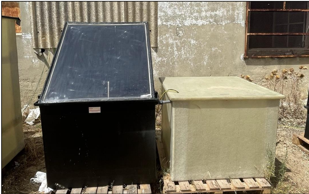
Figura II.5. Pormenor do tanque médio e o respetivo reservatório, instalados na empresa TechSalt, Loulé.
