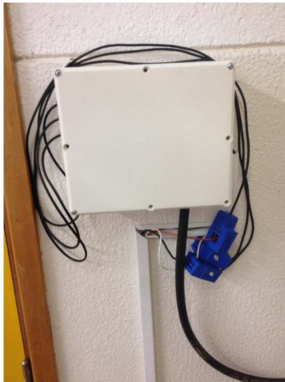
Figura 3.22 – Módulo de Medição dos Consumos Elétricos Trifásicos.
