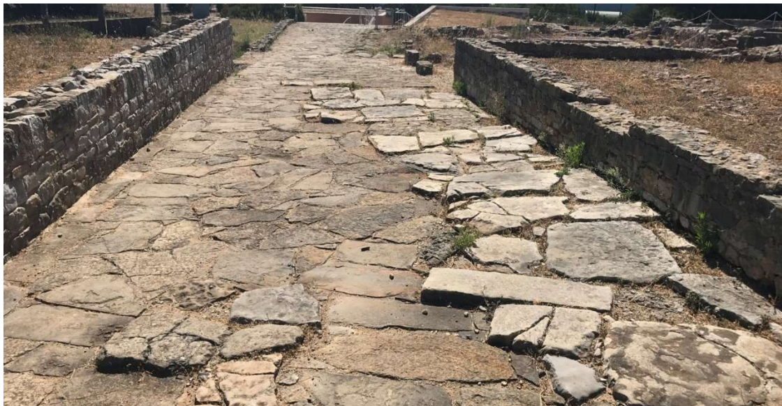
Figura 21 – : Vista do pavimento em laje de pedra. As lajes originais são mais irregulares e salientes. (Agosto 2019)
