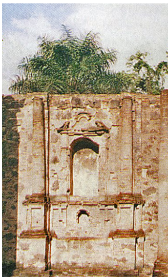
Belém. Capela da Fazenda Murucutu, pertença do arquiteto Landi. Vestígios do retábulo. Foto Isabel Mendonça
