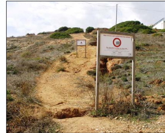
Arribas em risco de queda
