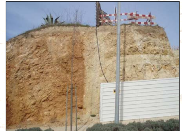
Aspecto actual da zona de falha no contacto Cretácico/Miocénico
