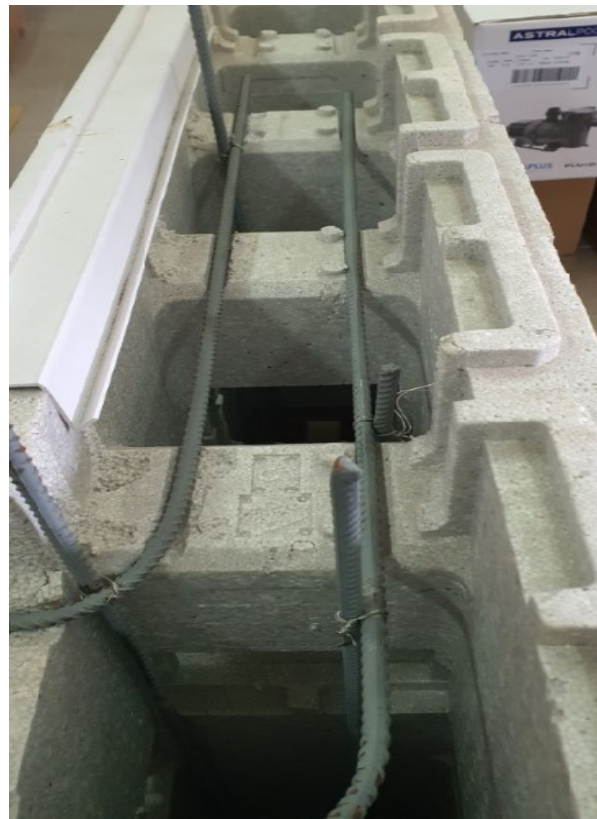
Figura 32 - Colocação das armaduras horizontais para formação da grelha - Fotografia cedida pelo Sr. Francisco Carmo (26/01/2023)
