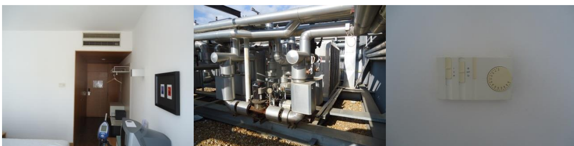
Figura 21 – Difusor localizado por cima da porta e sonómetro, unidade exterior e controlo.
