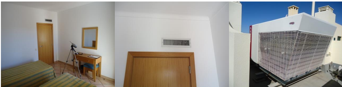
Figura 11 – Difusor localizado por cima da porta, sonómetro e equipamento no exterior.
