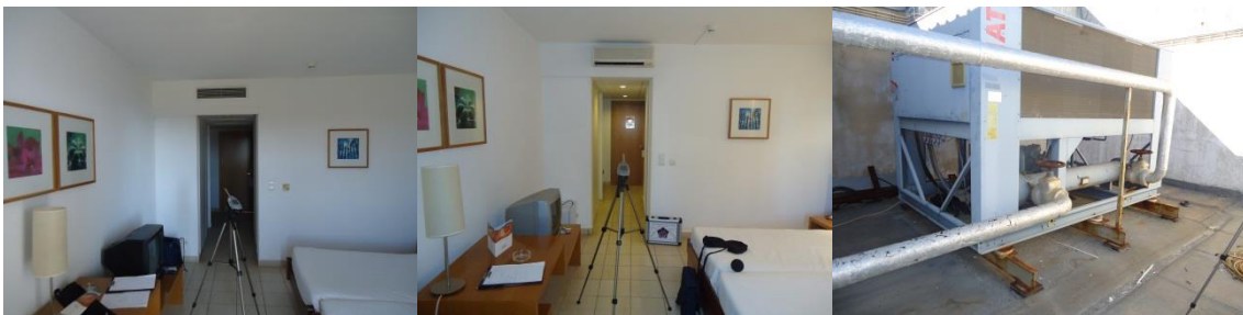
Figura 18 – Difusor localizado por cima da porta, sonómetro e unidade interior de climatização e chiller.
