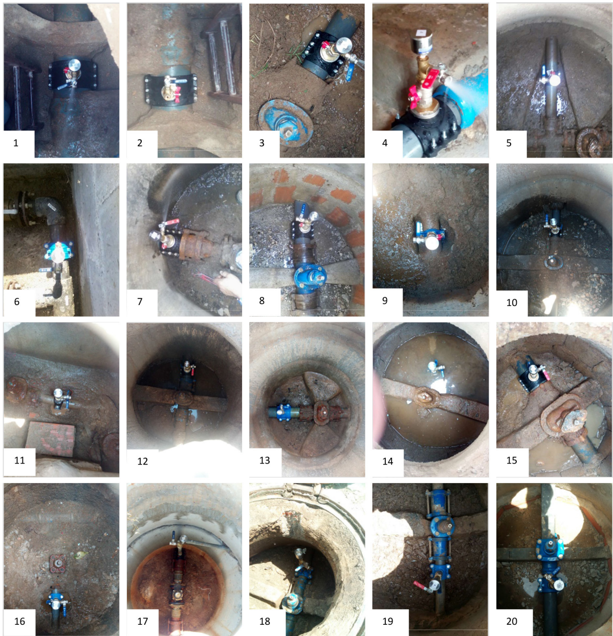
Figura 3.5: Instalação do datalogger nos 20 pontos de medição da pressão na rede de abastecimento de água de Reguengos de Monsaraz
