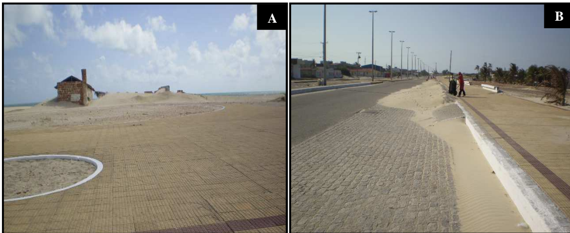
Figura 2.23 - A )Soterramento de uma barraca na Praia do Futuro por; B) Retirada de areias do calçadão e da avenida no trecho norte da Praia do Futuro.
