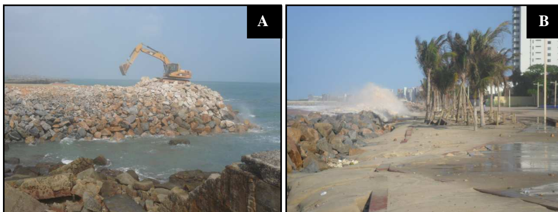
Figura 6.10 – Requalificação da Praia de Iracema - a construção de mais um espigão (A) e a recuperação do enrocamento e do calçadão (B). Na foto “B” é possível observar que a rebentação das ondas de ressaca ultrapassaram o enrocamento e atingiram o calçadão.
