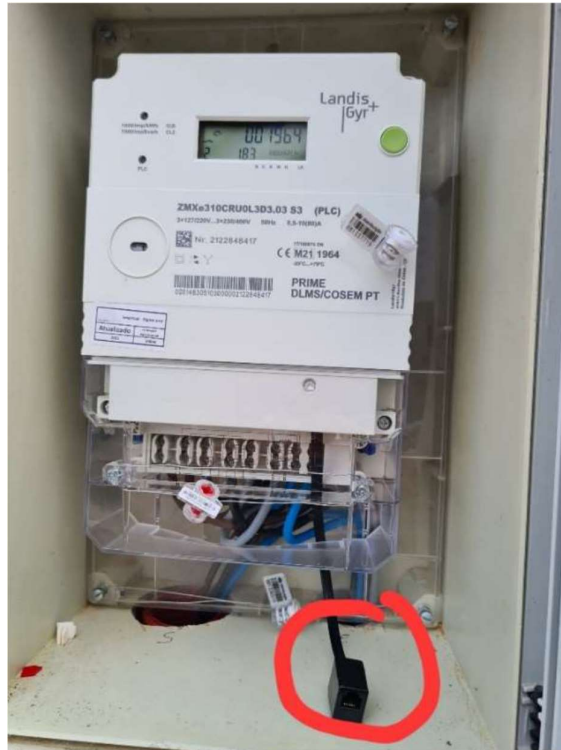
Figura 5.1 Porta HAN (Home Area Network) no contador elétrico da moradia
