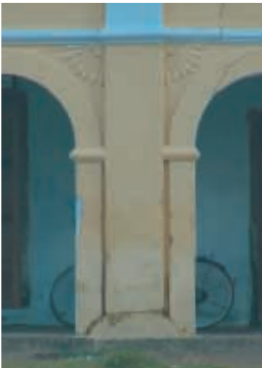
VISTA DA FACHADA PRINCIPAL E PORMENOR DA CASA PAROQUIAL DA IGREJA DE CHELLANAM. SUL DE COCHIM
