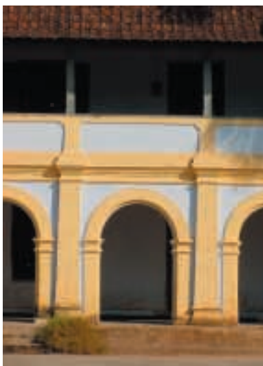
ALÇADO E PORMENOR DA FACHADA PRINCIPAL DA CASA PAROQUIAL DA IGREJA DE SÃO LOURENÇO DE EDACOCCHIM. SUL DE COCHIM
