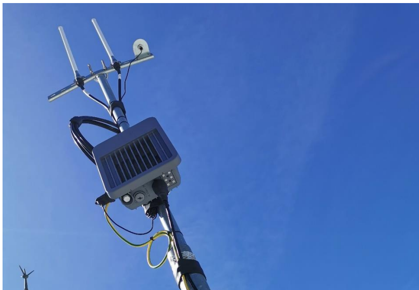
Figura 2.10 – SmartCity – Antena da rede LoRa
