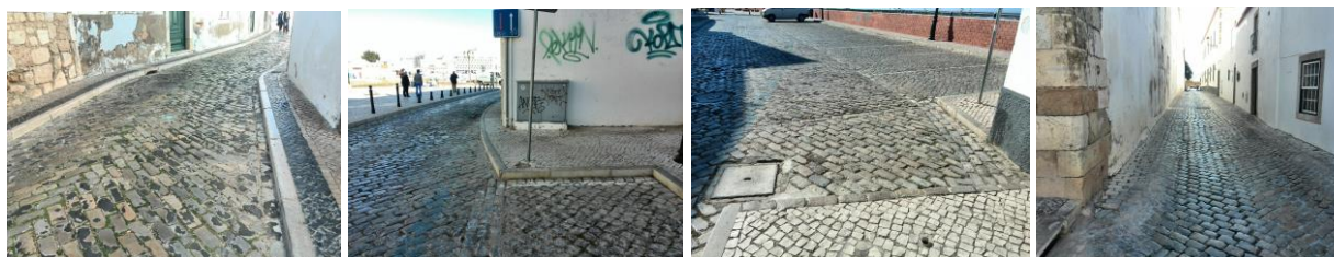
Figura 6.15 - Levantamento fotográfico das situações de subdimensionamento ou inexistência de passeio no Arco Arco do Repouso, na Rua Comandante Francisco Manuel e na Rua do Castelo. [12/03/2015]
