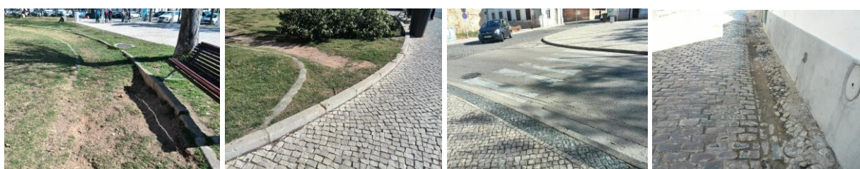
Figura 6.16 - Levantamento fotográfico das situações de pavimento irregular/degradado e de lancis como obstáculo/barreira, no Largo de São Francisco e na Rua do Trem. [12/03/2015]
