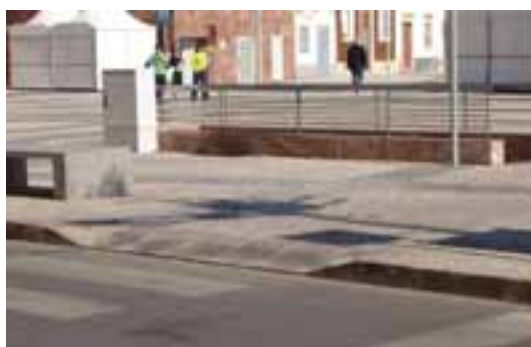
Largo da Pontinha – Rebaixamento de lancil com 20% de inclinação, inacessível às pessoas em cadeiras de rodas
