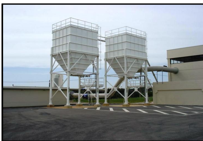
Figura 3.1.12 – Fase sólida – Silos de lamas desidratadas
