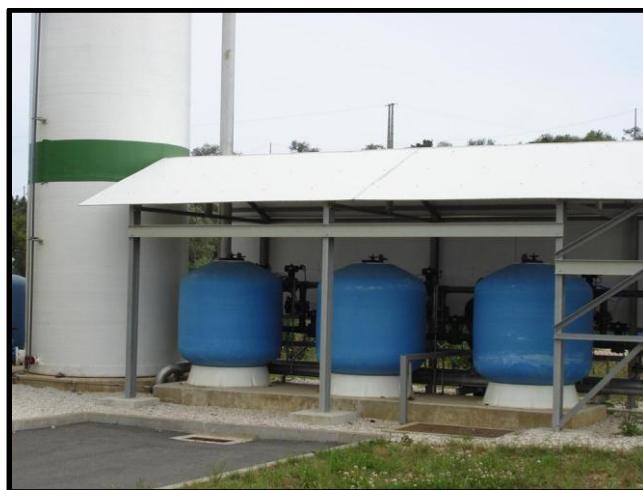
Figura 3.1.8 – Produção de água de serviço – Filtros de areia e reservatório de água de serviço
