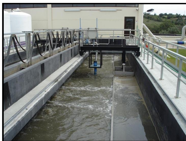
Figura 3.1.3 – Tratamento preliminar – Desarenadores/desengorduradores
