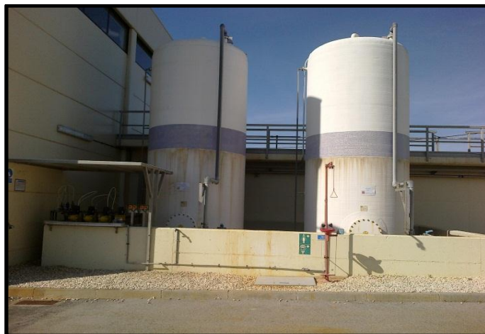
Figura 3.1.6 – Reservatórios de armazenamento do sulfato férrico
