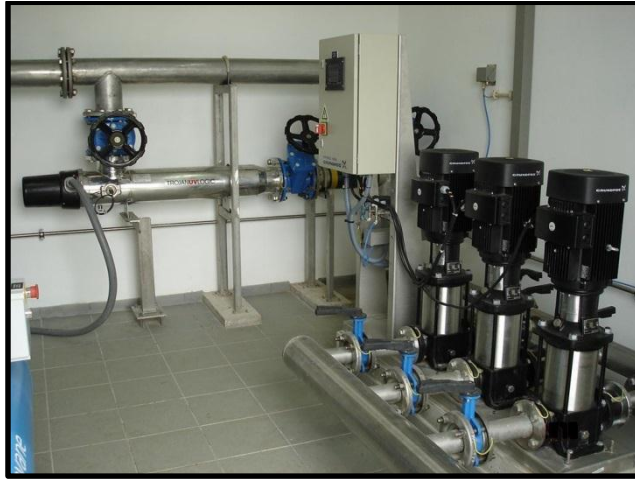
Figura 3.1.9 – Produção de água de serviço – Central hidropressora e sistema de desinfecção em conduta fechada
