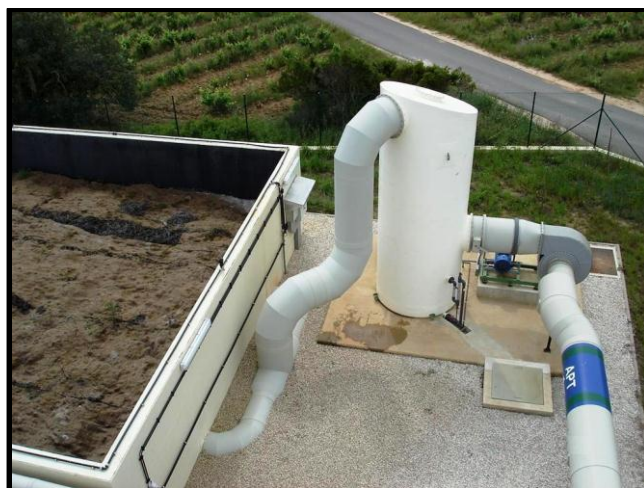
Figura 3.1.13 – Fase gasosa – ventilador, torre de lavagem e biofiltro
