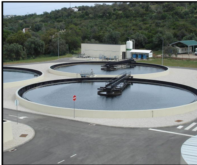
Figura 3.1.5. – Tratamento biológico – decantadores secundários
