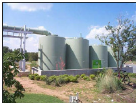
Figura 15 – Reservatórios em Aço
