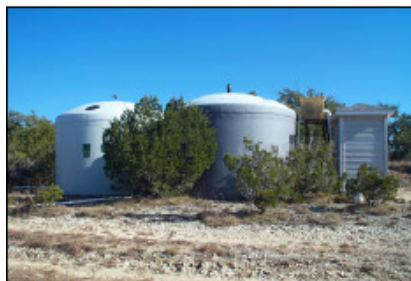
Figura 12 – Reservatório em Fibra de Vidro
