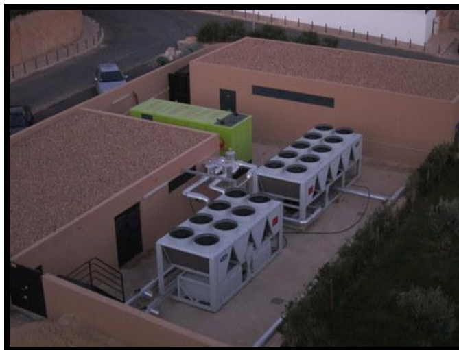
Fig. 18 – Central Técnica Exterior
