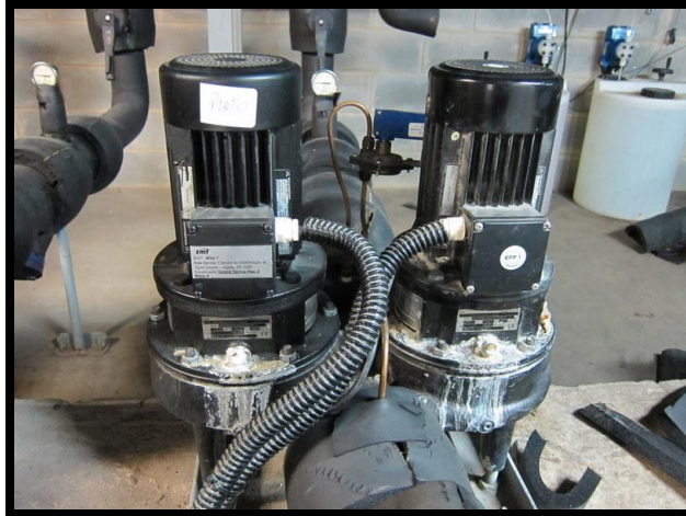
Fig. 24 – Bombas do circuito de distribuição de água quente
