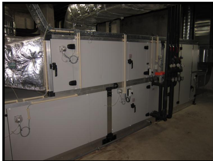
Fig. 13 - Unidade de Tratamento de Ar (UTA)
