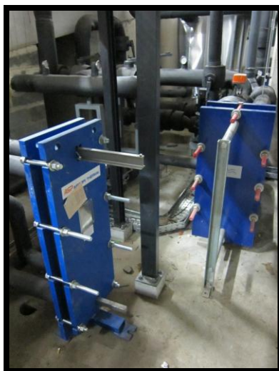
Fig. 23 – Permutadores de placas – Sistema solar
