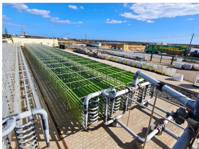
Figura 3 - Fotobiorreator tubular de 19 m 3
