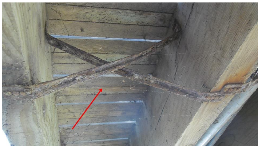
Fig. 5.17 - Corrosão acentuada dos elementos metálicos de contraventamento em pormenor das longarinas
