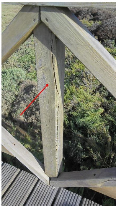
Fig. 5.8 – Fendilhação longitudinal numa peça do corrimão
