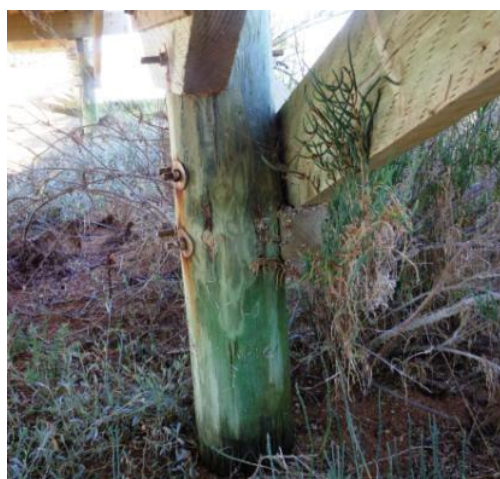
Fig. 5.13 – Ataque de fungos nos pilares, na zona em contacto com o solo
