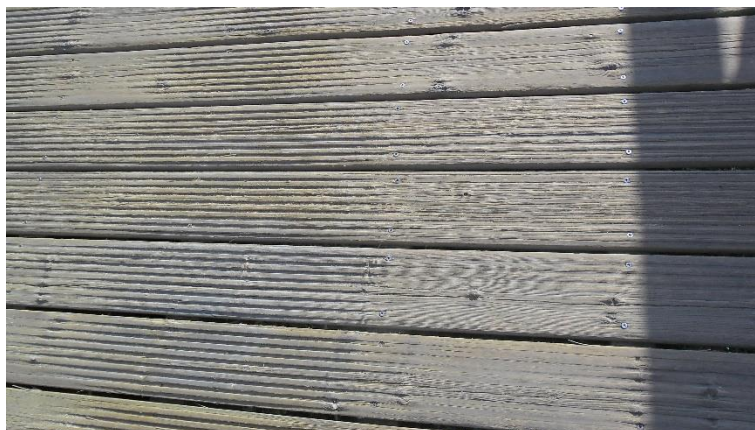
Fig. 5.12 – Desgaste das tábuas do pavimento
