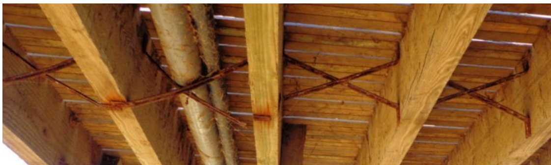
Fig. 5.16 - Corrosão acentuada e generalizada dos elementos metálicos de contraventamento das longarinas
