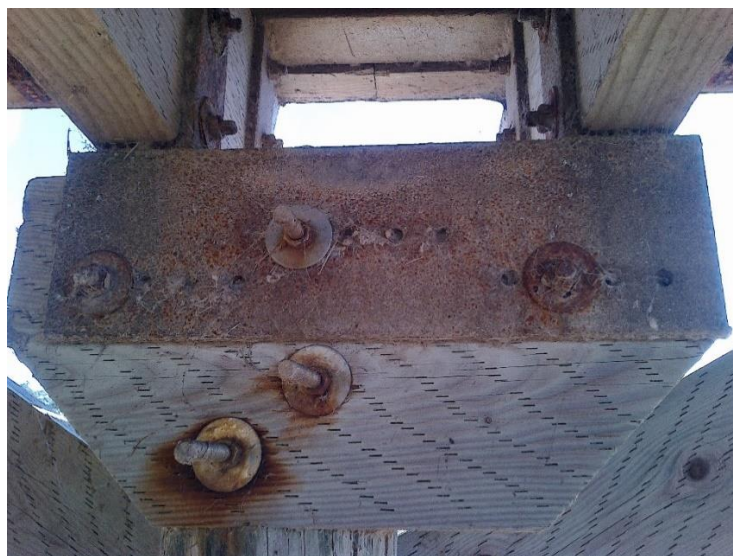
Fig. 5.15 – Corrosão da peça metálica que sustenta as vigas transversais (carlingas)
