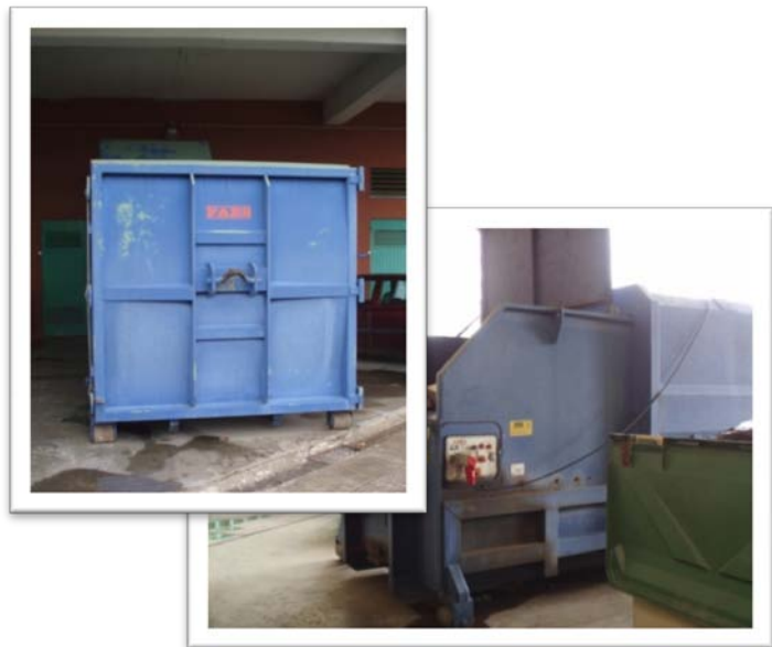
Figura 3 – Compactador de papelão utilizado na UHP/CHBA para compactar e armazenar o papel antes ser recolhido pela ALGAR.
