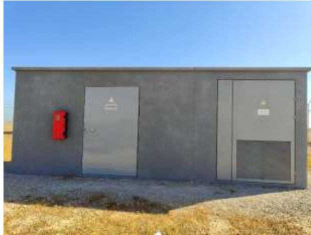
Figura 3.10 - Posto de Transformação da central fotovoltaica do AGC.
