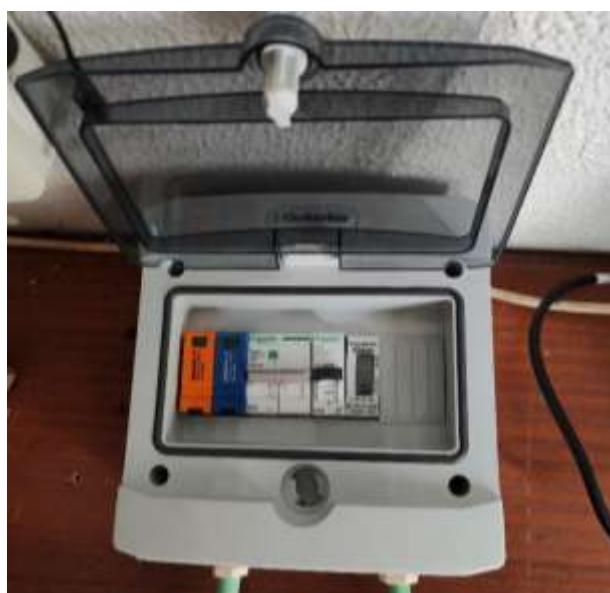
Figura 3.45 - Quadro elétrico do ensaio experimental.
