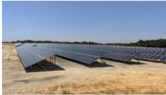
Figura 3.6 - Central Fotovoltaica AGC.
