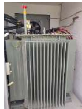
Figura 3.9 - Transformador Elevador 800/15000V.
