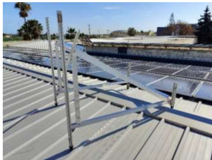
Figura 3.50 - Estrutura de alumínio de suporte para os painéis.
