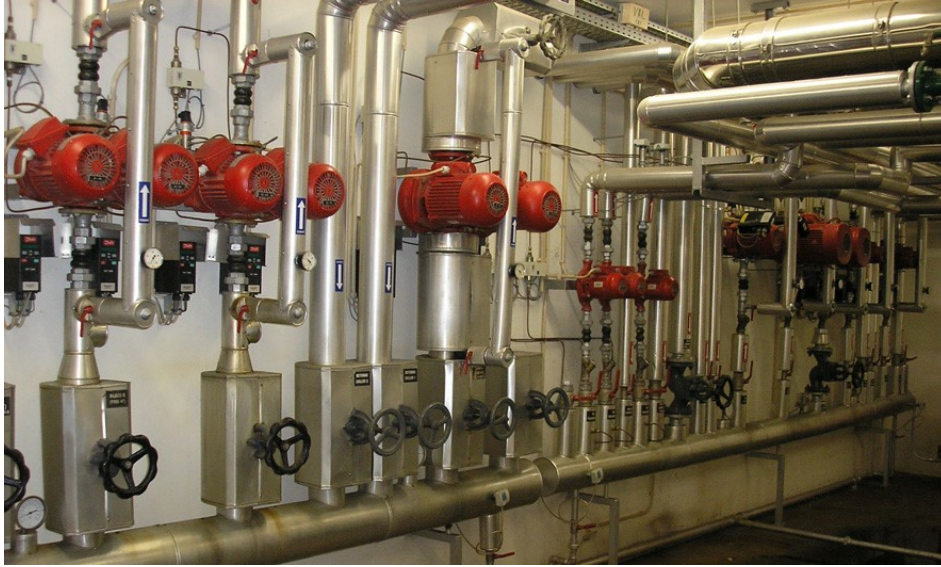
Figura 12 - Eletrobombas de Circulação de Água
