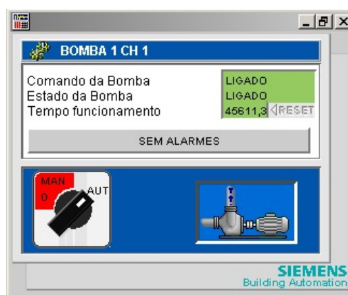
Figura 31 - Funcionamento bomba recirculadora chiller nº1 [5]
