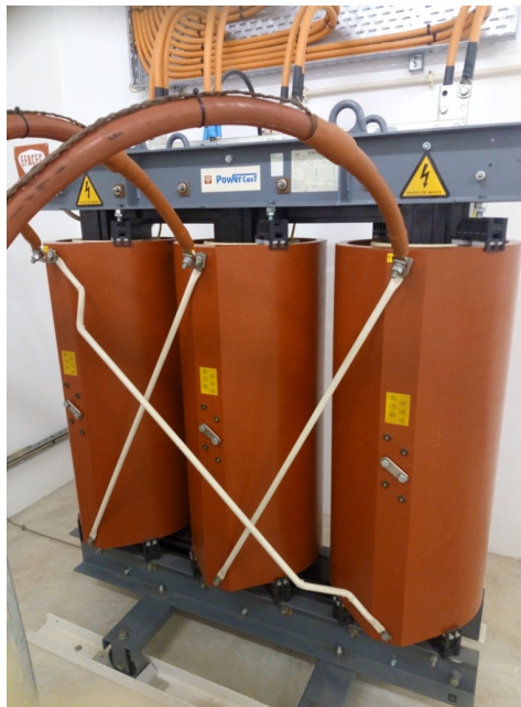
Figura 19 - Posto de transformação
