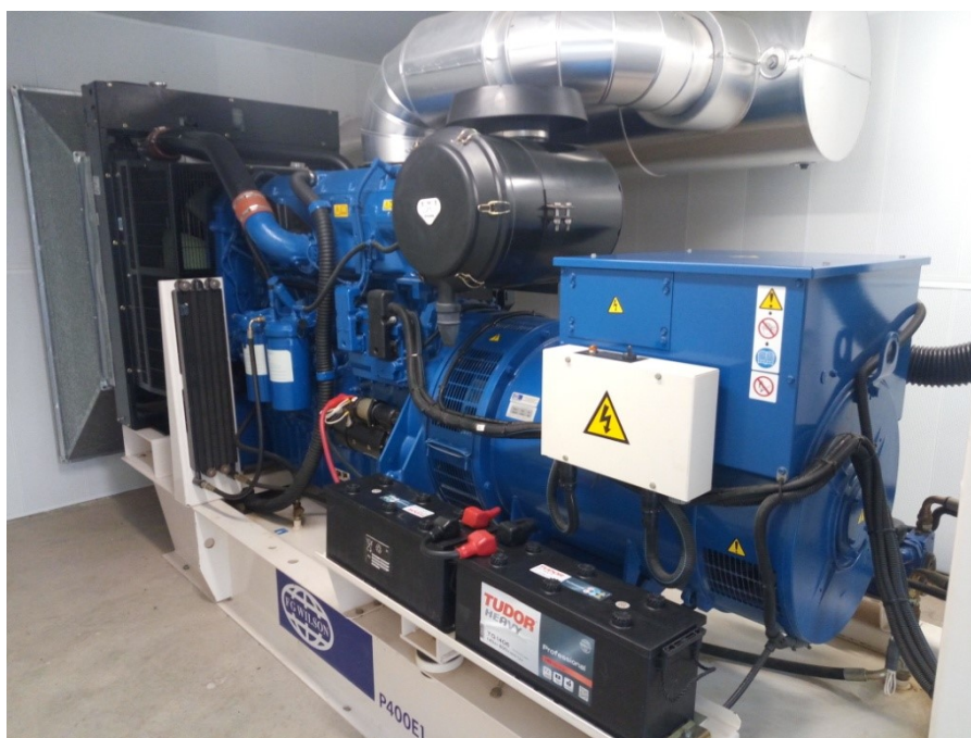
Figura 20 - Gerador de emergência
