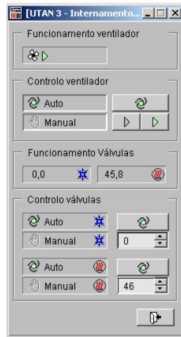
Figura 39 - Controlo UTAN nº3 [5]
