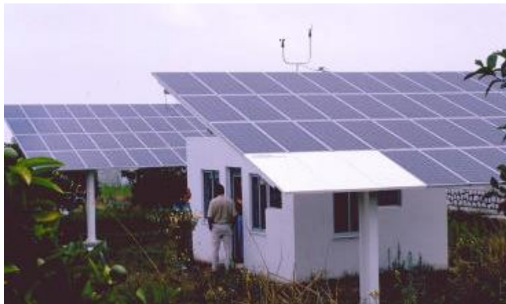
Figura 3.3 – Sistema fotovoltaico para bombagem de água
