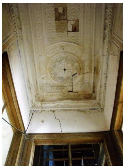
Figura 4.19: Fissuras no teto da caixa de escadas.
