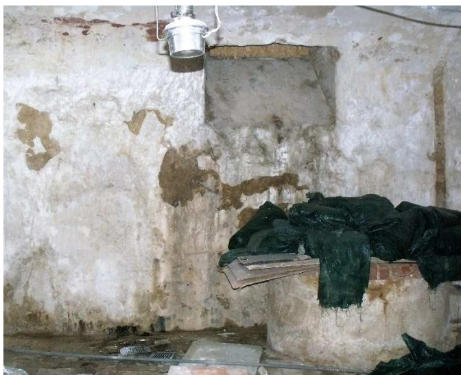
Figura 4.20: Indícios de eflorescências e infiltração na parede orientada a nordeste.
