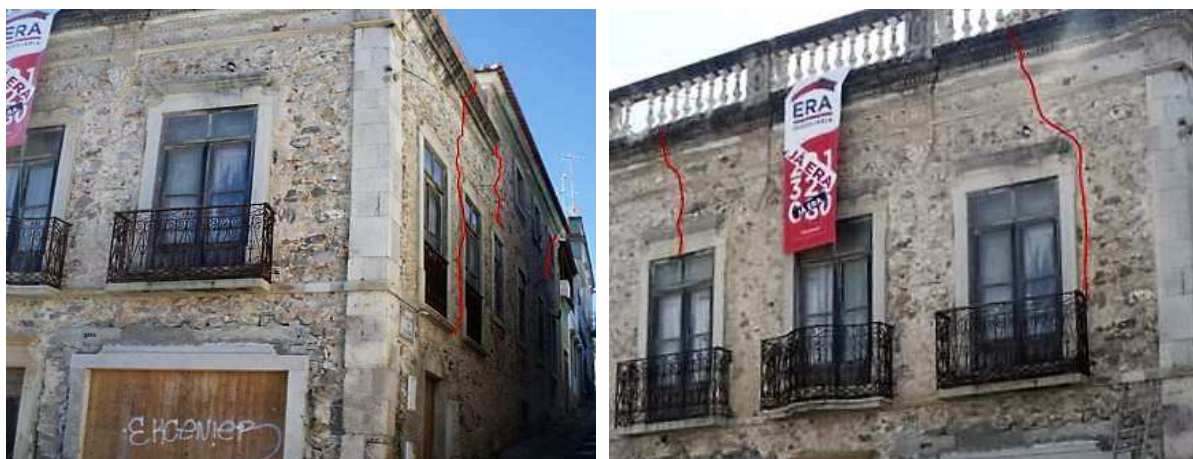
Figura 4.14: Fendas nos paramentos exteriores: fachada nordeste (esquerda) e fachada noroeste (direita).
