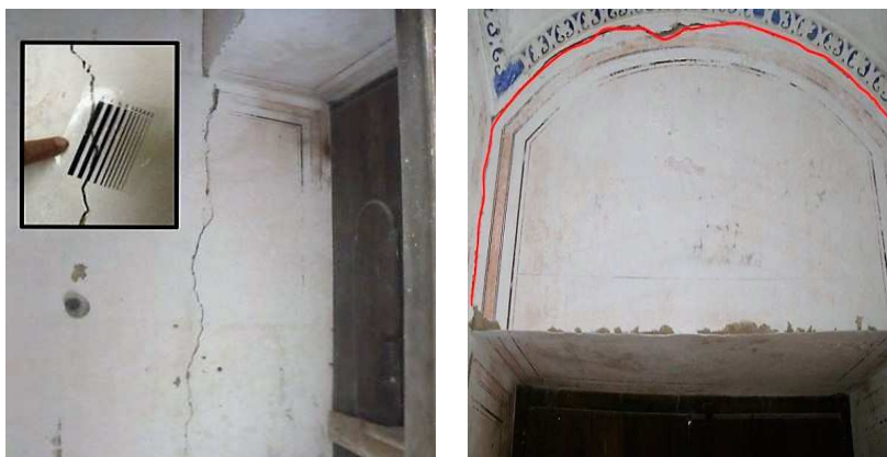
Figura 4.17: Fissuras no piso térreo: vertical (à esquerda) e na ligação da abóboda a parede (à direita).
