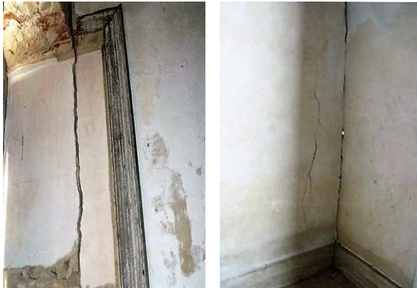
Figura 4.18: Manifestação de fissuras relevantes no primeiro piso.
