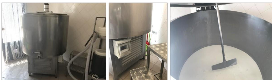
Figura 5.3 - Tanque de refrigeração (Fotos Alexandre Cunha, 2018).
