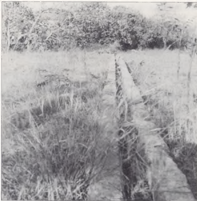
Um pormenor da conduta da água que atravessava a Rua Nova de Quarteira, proveniente de uma nora que ainda se encontra propriedade vizinha.
