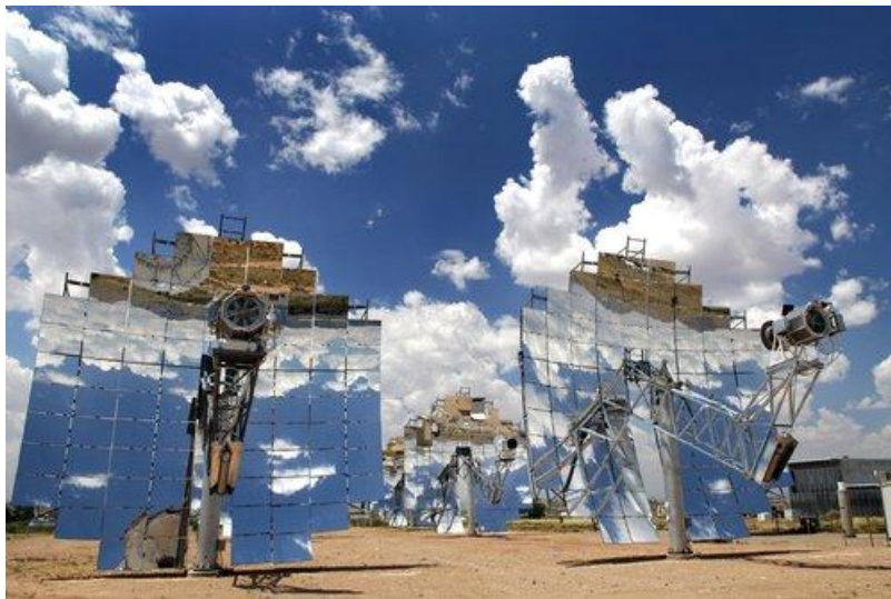
Figura 3.5 – Sistema solar de geração de electricidade por meio dum motor Stirling operado com radiação solar focada por um prato reflector (Sandia National Laboratory).
