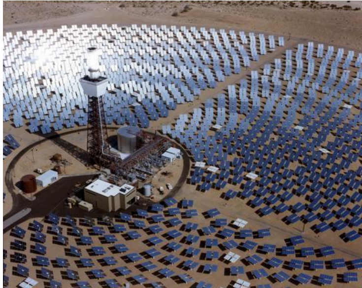
Figura 3.6 – Estação experimental Solar Two, de helióstatos de recepção central (Sandia National Laboratory).
