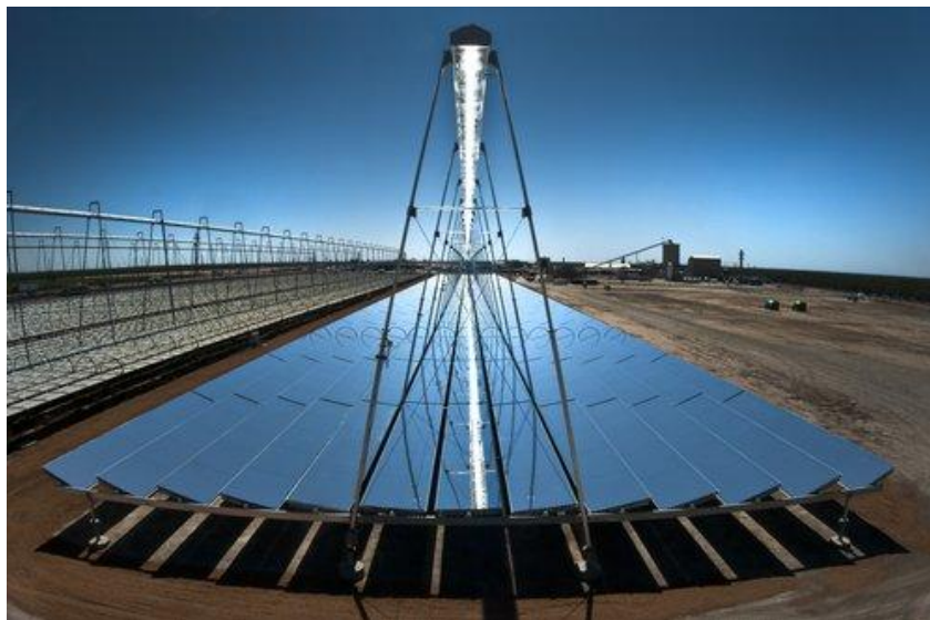
Figura 3.4 – Tecnologia de reflectores lineares compactos de Fresnel, instalados pela AREVA na sua central de produção solar termo-eléctrica Kimberlina, em Bakersfield, California (AREVA Solar).
